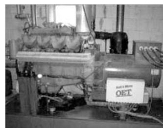
Bio-Elektro-toplinski uređaj BHKW2
